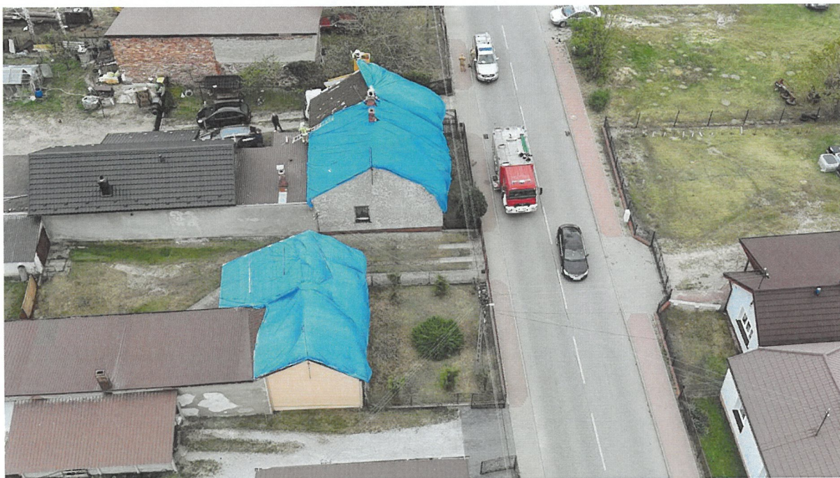
Fot. Działania zabezpieczające uszkodzony dach, 05.05.2025r. Źródło: materiały własne KM PSP w Piotrkowie Tryb.
